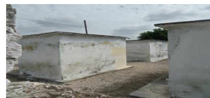
Bóvedas manchadas por la filtración
