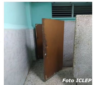
Foto ICLEP Baños Sala Uno
