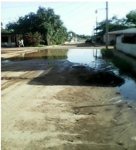
Hueco en la vía
