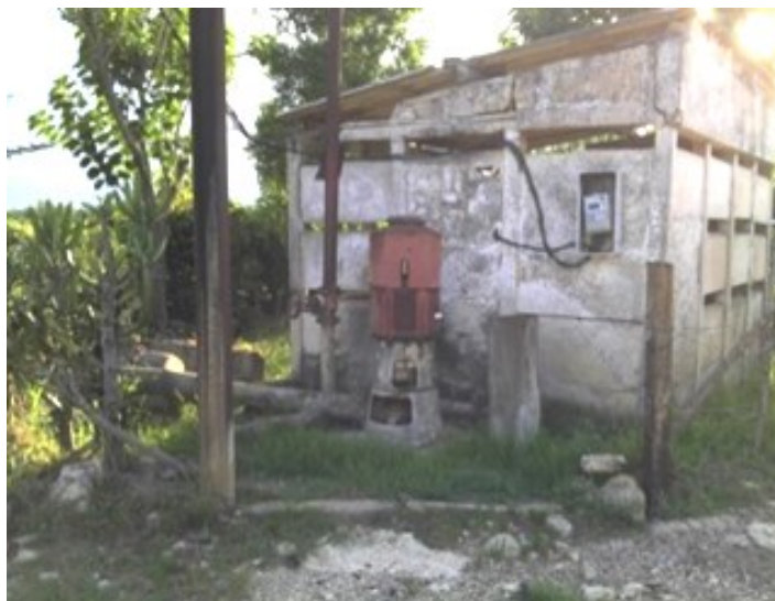
Instalación que proveía de agua al batey Deseada
