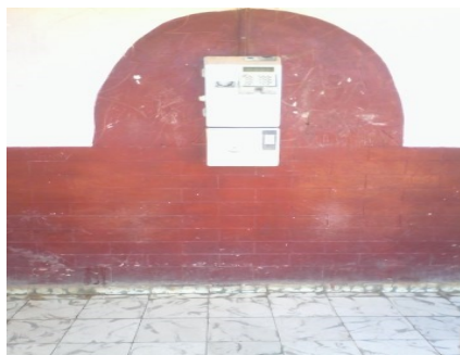
Teléfono fuera de servicio
