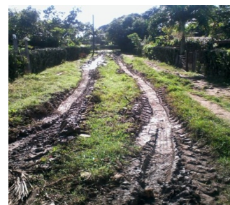
Vía en mal estado
