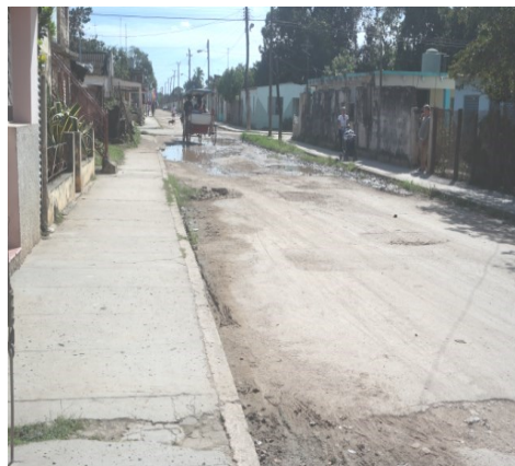
Bache en la Calle Varona
