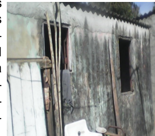
Casa en mal estado
