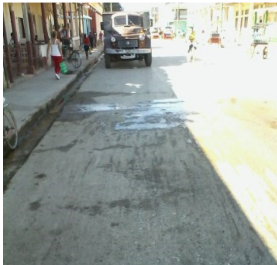
Salidero de agua potable, Calle Mario Muñoz
