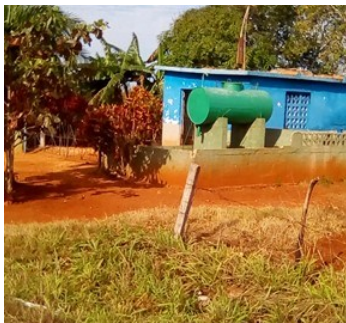
Casa de bombeo. Foto: ICLEP
