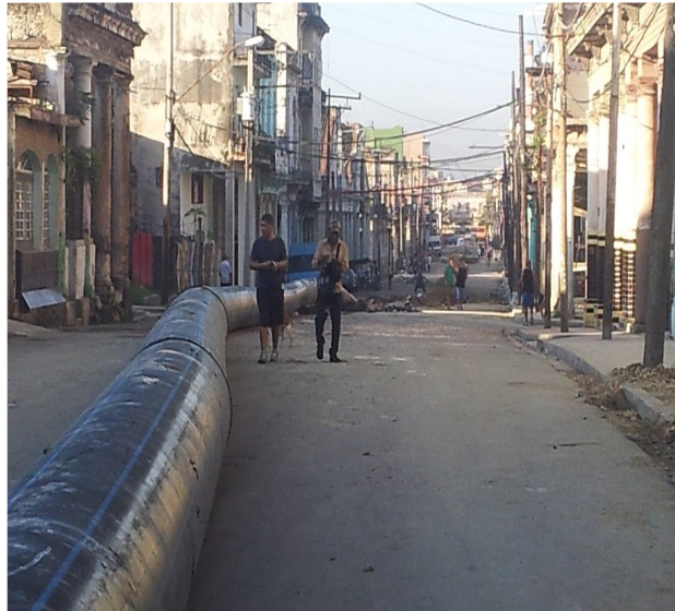
Vives, una de las calles obstruida por las reparaciones
