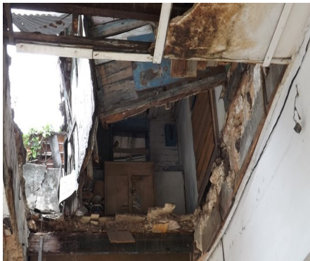
Piso de la vivienda derrumbada
