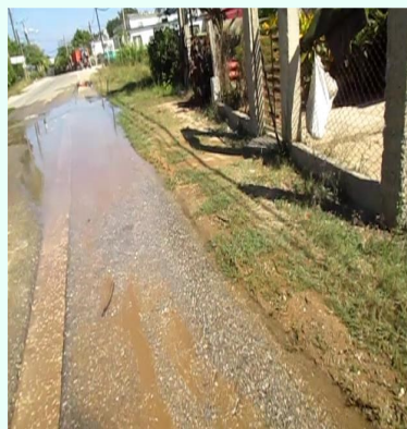
Imagen del salidero de agua
