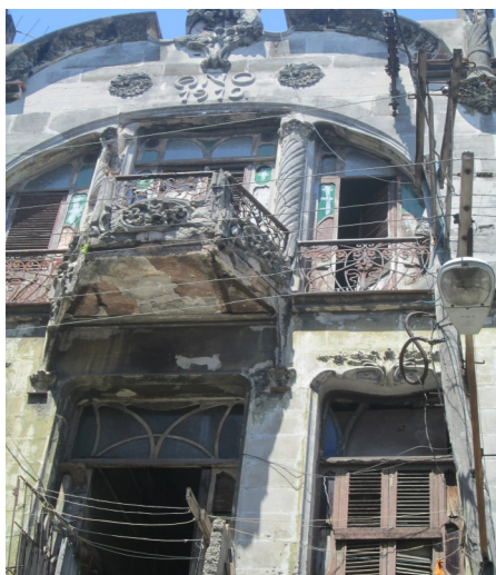
Fachada de uno de los edificios en mal estado
