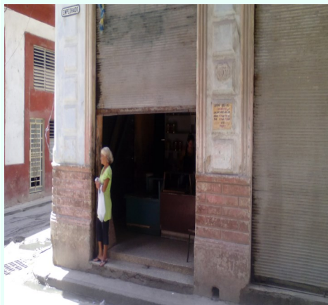
Imagen de uno de los locales afectados
