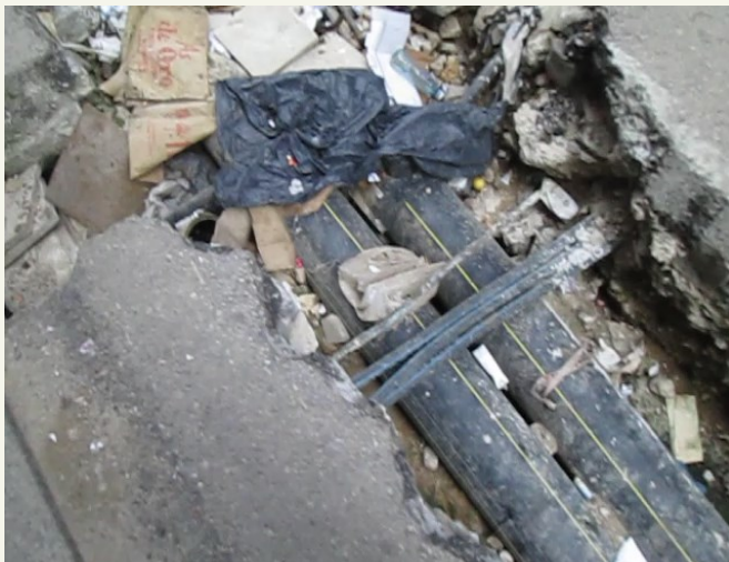
Imagen de una de las vías sin ser reparadas
