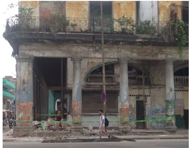
Edificación ubicada en Esquina Egido y Corrales, afectada por derrumbe parcial
