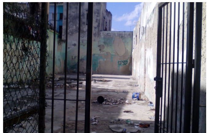
Imagen del local deportivo en su deterioro
