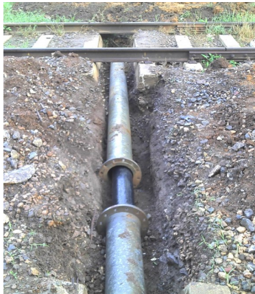
Conductora de agua que enlaza la zona afectada. Foto del autor
