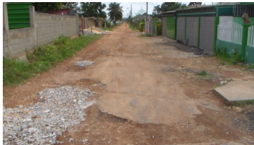
Calle que espera ser asfaltada, después que realizaran esa promesa.
