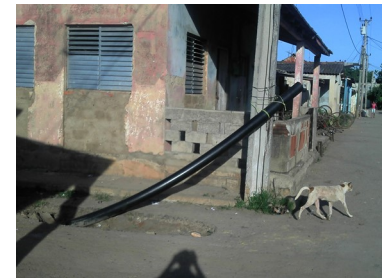
Tubería que para el abasto de agua potable, fue abandonada su continuación
