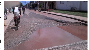
Bache que ha ocasionado accidentes
