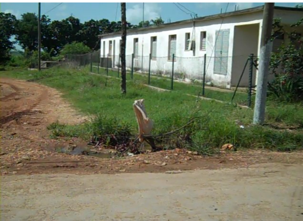
Avería en la tubería de agua, que aún no ha sido solucionada
