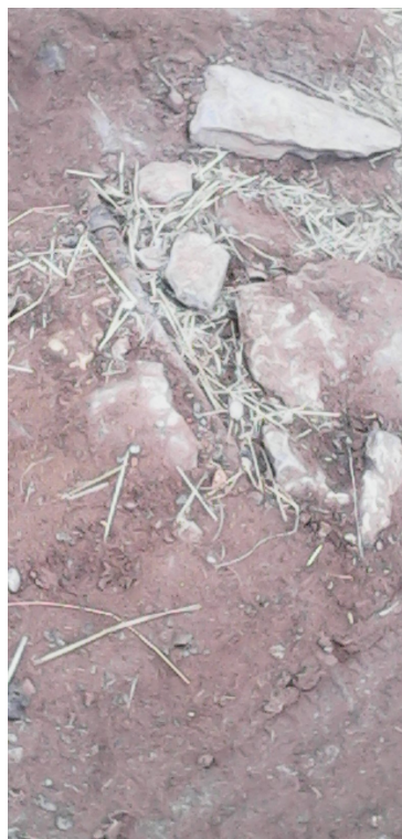
Tubería afectada por el paso de los vehículos de la zona
