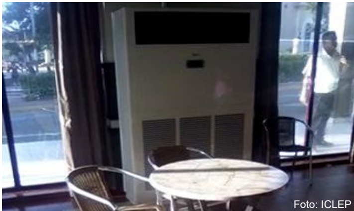
Nuevos equipos de climatización
