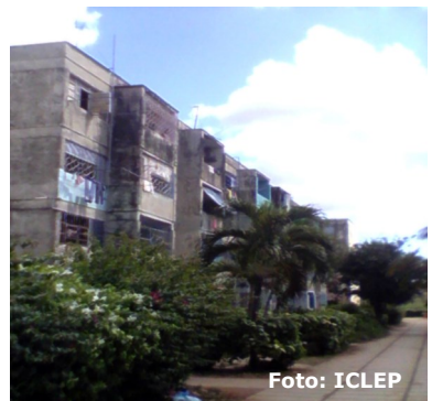
Foto: ICLEP Edificio con peligro de derrumbe, ubicado en San Cristóbal.
