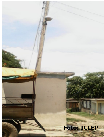
Foto: ICLEP Poste de luz de la calle 36.
