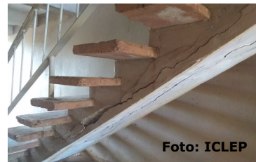
Foto: ICLEP Escaleras en peligro de derrumbe.
