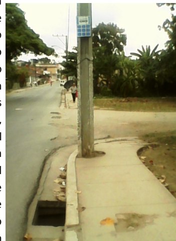
Hueco en la parada de la ruta 4, en la calle Galiano.
