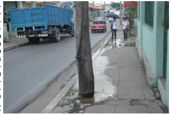
Poste eléctrico de donde sale el agua albañal
