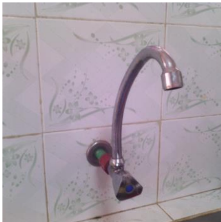
Grifo de agua de la vivienda de Katia donde no llega el preciado líquido
