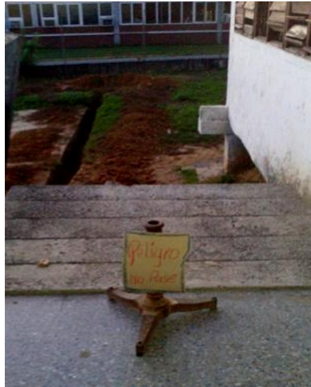
Señal de peligro en escuela por reparación
