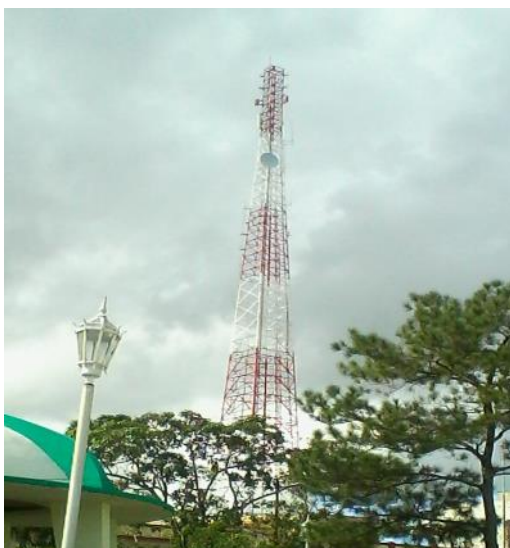
Torre principal de ETECSA en Pinar del Río
