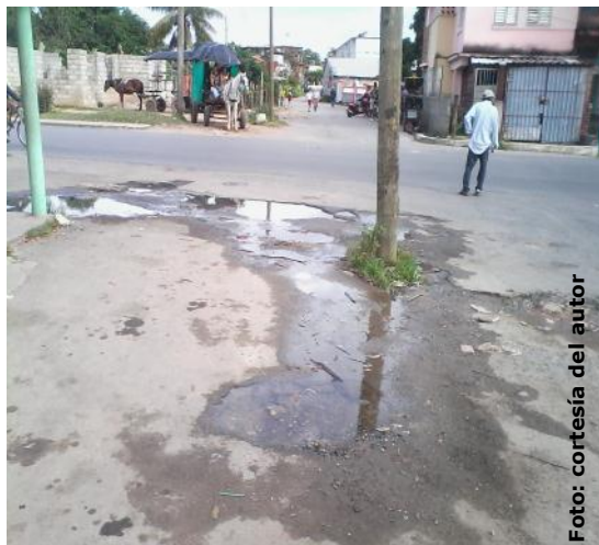
Fosa reventada en entrada Reparto Carlos Hidalgo.
