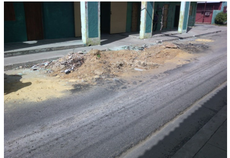
Obras inconclusa que obstruye la vía pública
