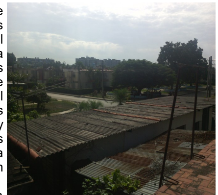
Viviendas en malas condiciones
