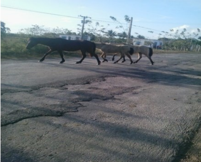
Vial con peligro para el tránsito
