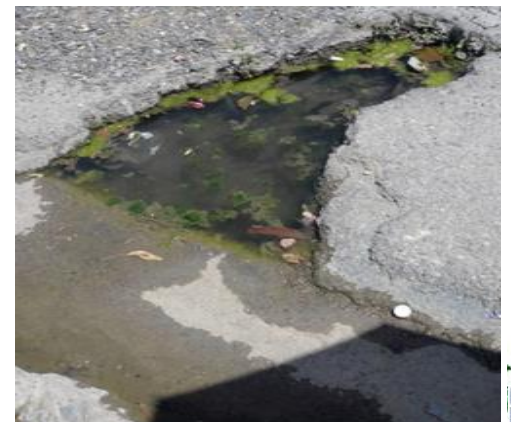
Hueco en la calle 1ro de mayo
