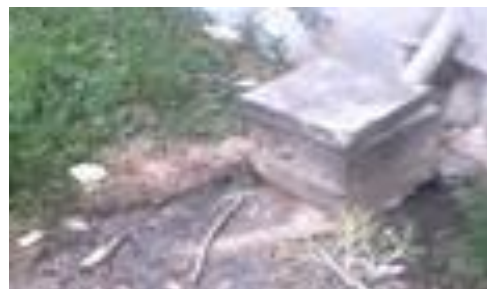
Registro de aguas albañales.
