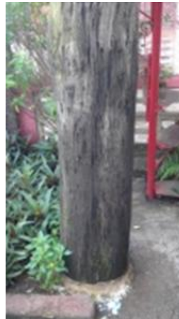
Poste en mal estado.
