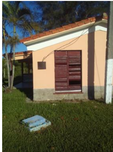
Imagen de ventanal deteriorado en la instalación.
