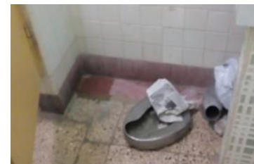
Imagen tomada en uno de los baños del Hospital mencionado, ubicado en la cabecera provincial pinareña.
