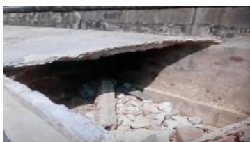
Imagen de una calle destruida por el Huracán.
