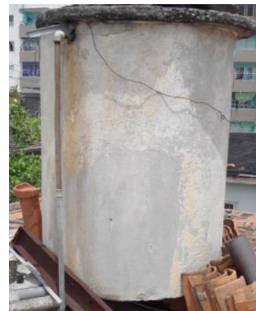
Imagen de un tanque de almacenar agua potable.
