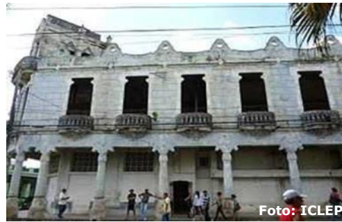
Emblemático Hotel Comercio enclavado en el centro del casco urbano, hoy en ruinas por falta de gestión de los Órganos de Administración Pública de la provincia. Otra de las edificaciones destruidas en la ciudad pinareñas.
