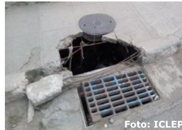
Hueco que ha provocado varios accidentes y la muerte de un joven.
