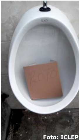
Foto: ICLEP Inodoro roto en el baño del centro mencionado.
