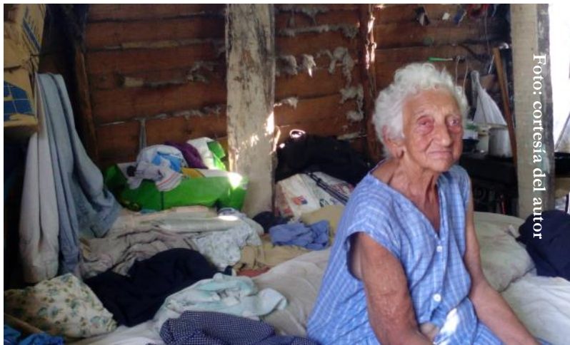
Paula muestra en el interior de su casa, como ha tenido que cubrir con lana, las grietas de las paredes para protegerse del frío y la lluvia.
