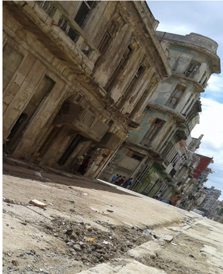
Imagen del inmueble destruido
