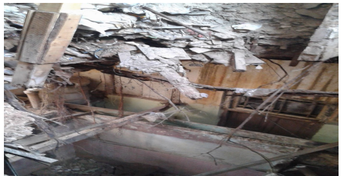
Imagen del techo de la vivienda afectada
