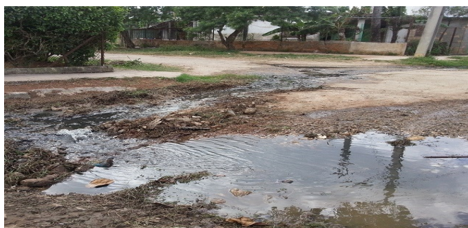
Imagen de aguas negras en las calles
