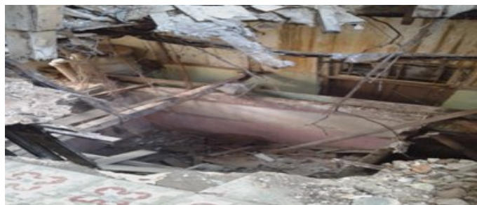
Imagen del colapso ocurrido en el inmueble 401 en enero
