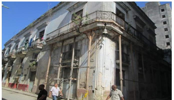
Imagen del inmueble en mal estado
