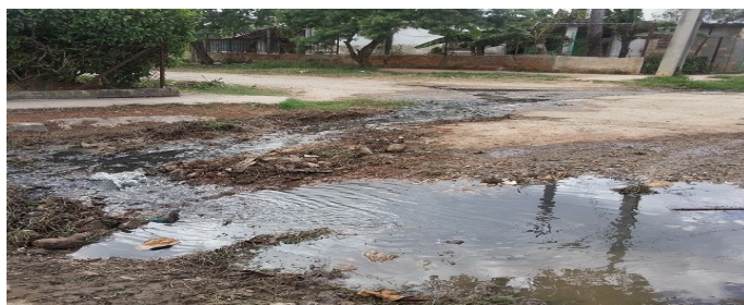
Imagen de aguas negras en las calles
