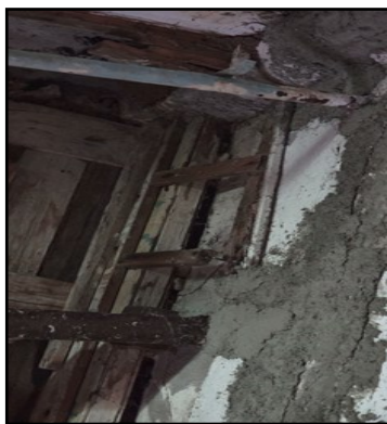
Las grietas en las paredes del edificio (Foto ICLEP).
