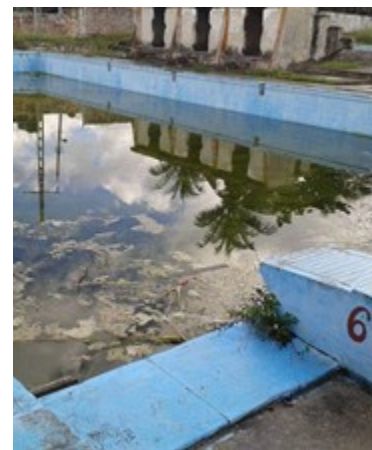
El área de piscinas se encuentra totalmente destruida (Fotos ICLEP).
