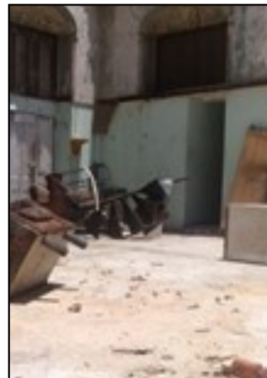
Restos del derrumbe del edificio de Monte 57 (Foto ICLEP).
