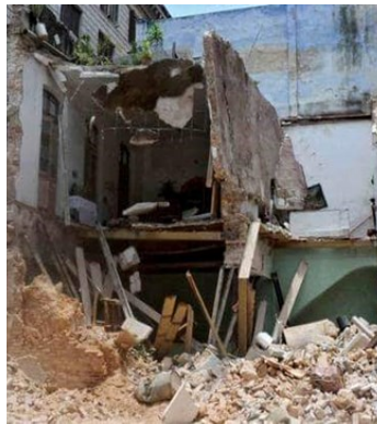
Al menos cinco derrumbes han tenido lugar en La Habana durante el 2019 (Foto ICLEP).
