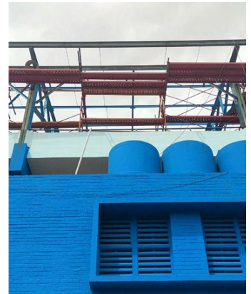
Los techos del estadio en varias zonas permanecen sin cubierta (Foto ICLEP).
