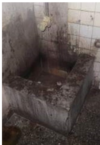
Poceta de desagüe llena de mugre, en los baños del hospital Hija de Galicia (Foto ICLEP).
