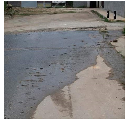
Los salideros de agua aparecen en múltiples calles del municipio 10 de Octubre (Foto ICLEP).
